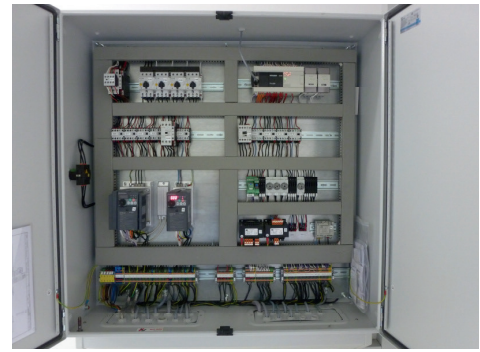
Appareils de commutation avec unité de commande SPS sans entretien
