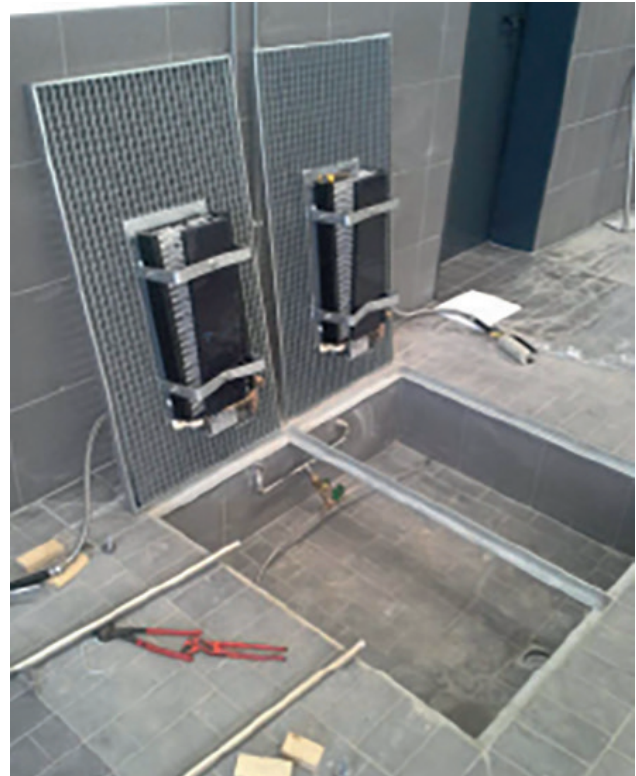
Schachtconstructie van een dubbele installatie
